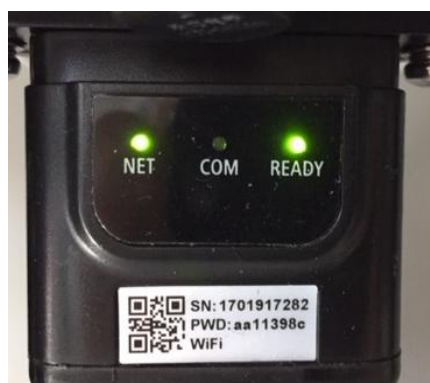
Figura 88 - Stato di comunicazione irregolare tra inverter e scheda
